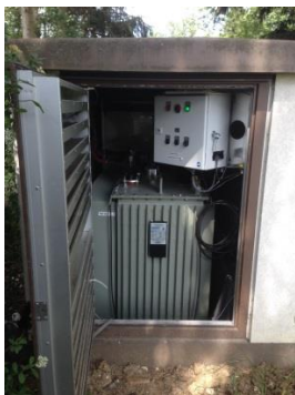
Bei der hier gezeigten Einbauart sind die Trafo-Anschlüsse berührungssicher ausgeführt.
