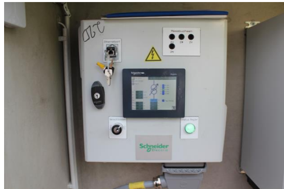
Steuerschrank im separaten IKT-Bereich der links abgebildeten Kompaktstation
