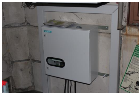
Steuerschrank an der rechten Innenwand der links abgebildeten Turmstation (Steuerkabel im Kabelkeller verlegt)
