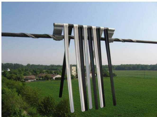
Bild 3: Verdrehung der Markierung durch nicht fachgerechten Einbau
