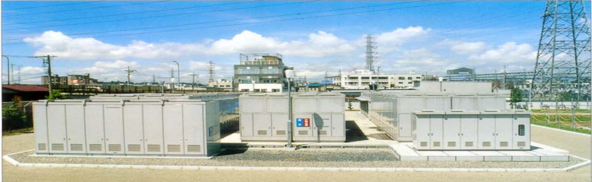
Abb. 9: Natrium-Schwefel-Hochtemperaturbatterie für den Load-Levelling-Betrieb (Tokyo Electric Power Company, Tsunashima – 6 MW, 48 MWh)
